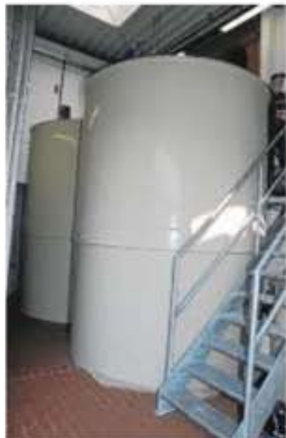
Erste Stufe: Während in dem Anlagenteil auf dem Bild oben die zweite Stufe der Reinigung durchgeführt wird, läuft in diesen beiden Behältern die erste Reinigungsstufe ab.
